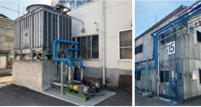
冷却用水を川水からクーリングタワー水に変更（資源水の使用量の削減）
